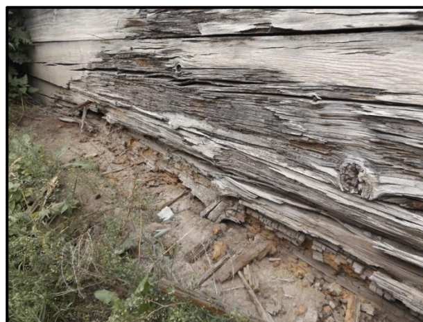
Рис. 2. Погружение части фундамента в грунт и биодеструкция нижних венцов сруба
