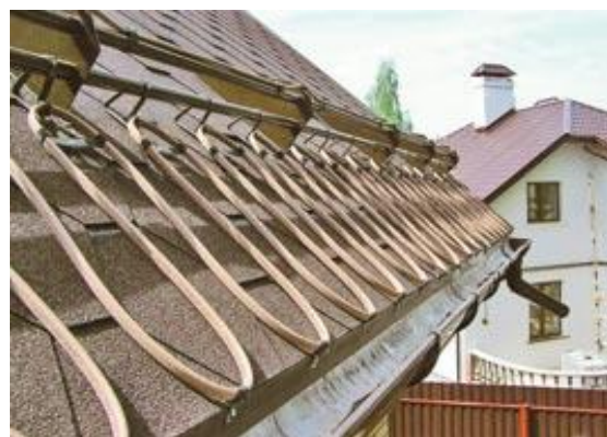
Рис. 2. Система антиобледенения крыши, изготовленная на основе греющего кабеля
