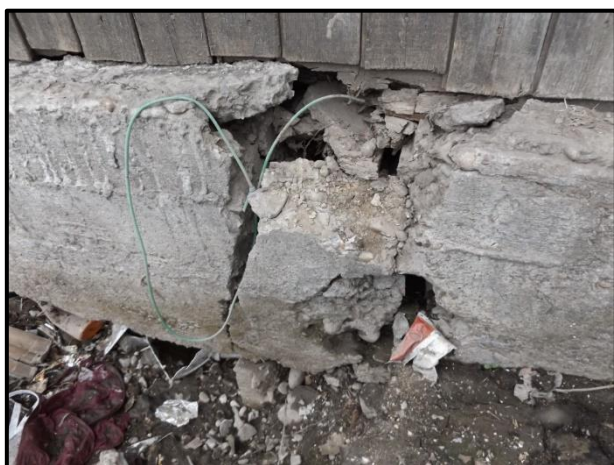
Рис. 1. Разрушение и деформация монолитной ленты фундамента
